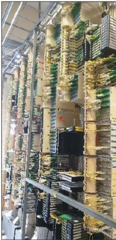
Noeud de raccordement Optique (NRO) de Lannion
